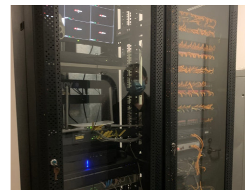
网络设备机房布线及安装调试
